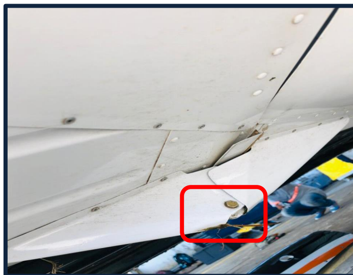
Fotografía No. 6 Vista de daños en soporte de flaps del ala izquierda.
